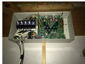
経年変化による昇圧装置の不具合
