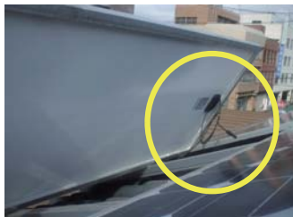
点検の後の配線忘れもありました。
